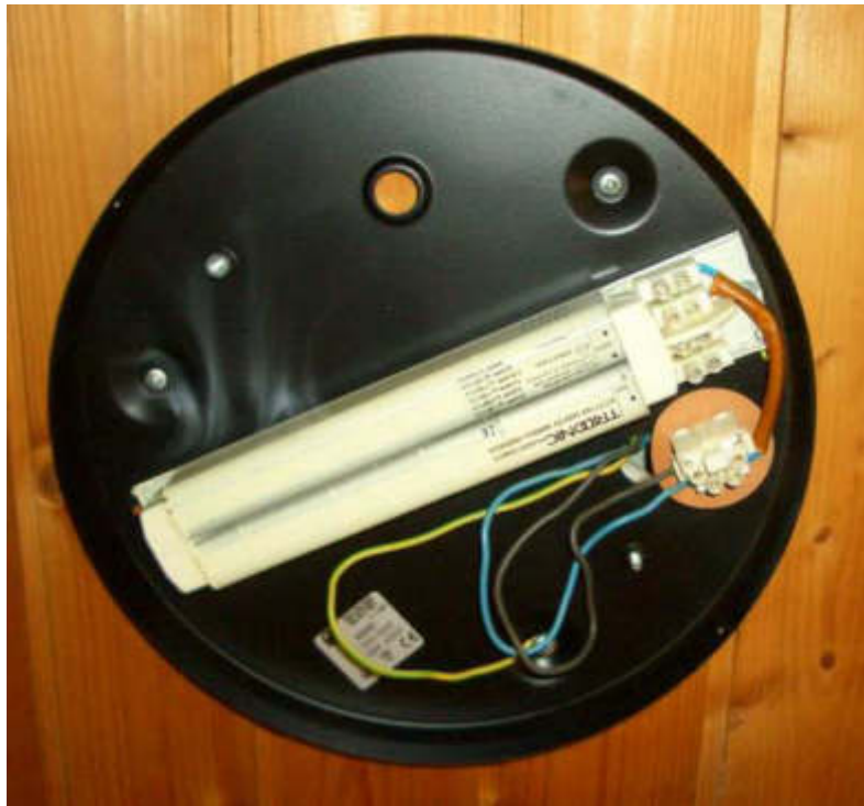
Deckenteil mit Trafo
