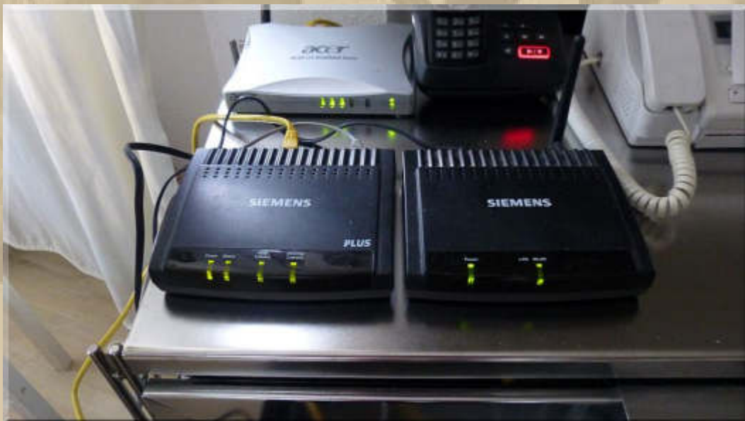
Siemens Modem & Siemens WLAN
